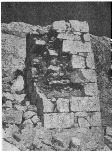
Foto 8. — Detalle de la construcción de un contrafuerte. Las piedras labradas forman una especie de encofrado, el cual está relleno de piedras sin labrar y argamasa.
